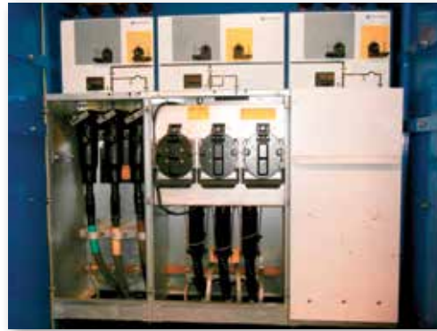
Cellule HTA 2 I + 1 P intégrée dans le local PIRATE
