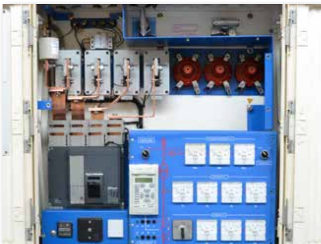
Coffret de contrôle et protection du départ BT
